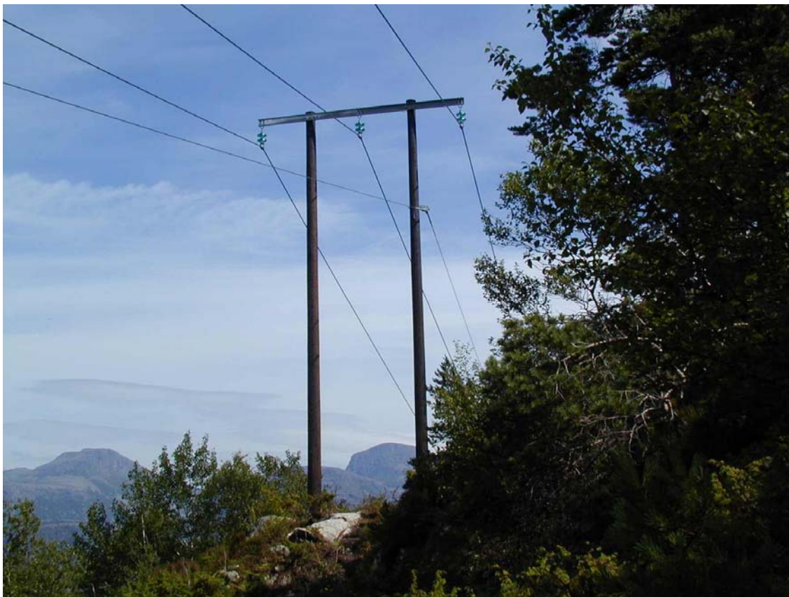
Figur 9 Foto av eksempelmast 22 kV-ledning
