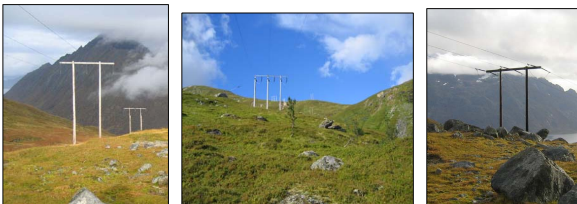
Figur 3.5 Bilder fra 132 kV linje bygget med tremaster
