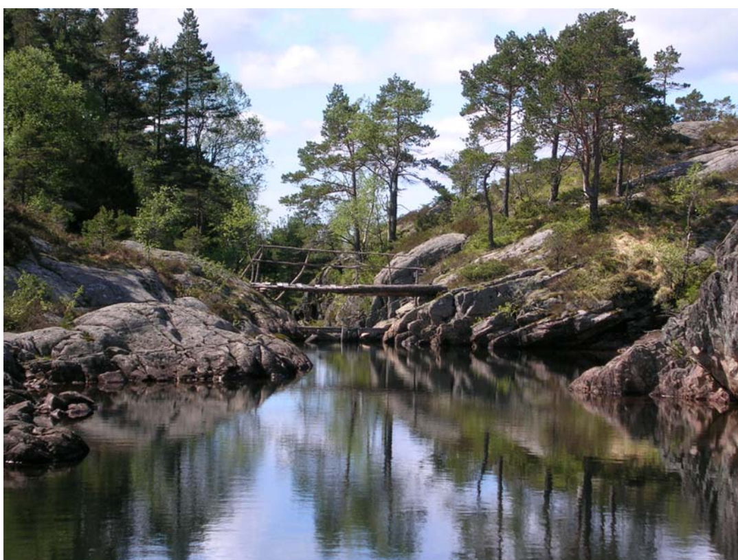
Figur 6: Bildet viser eksisterende stem. Dagens stem består av gammel plank og enkelte heller og er i dårlig forfatning. Bildet viser vannstanden i dag når det går omtrent normalvannføring i elva.
