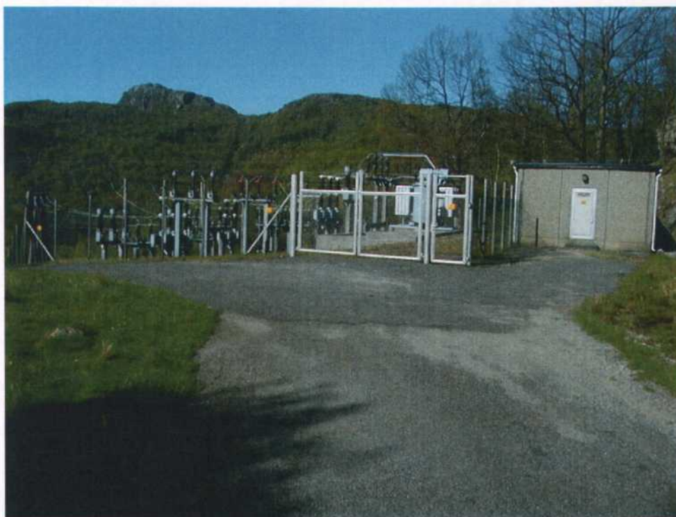
Bilde 1 - Sandsmork transformatorstasjon
