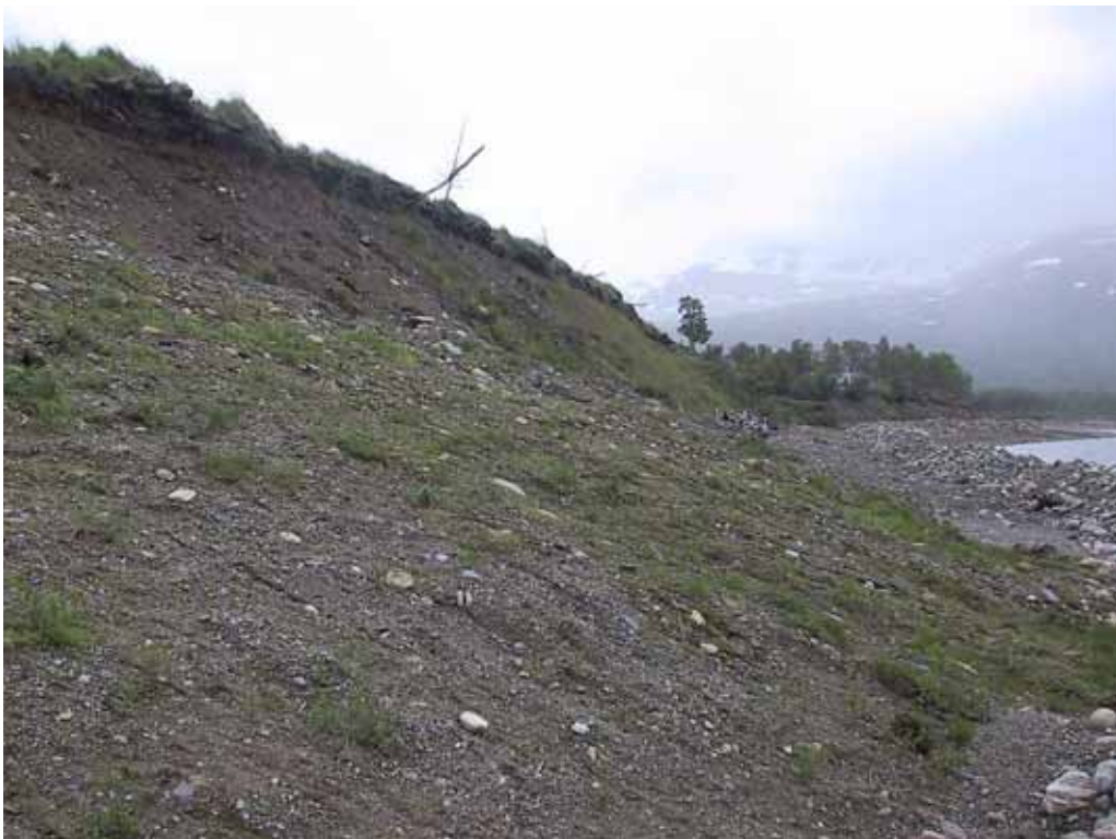
Foto 21 viser situasjonen før erosjonsforebyggende tiltak ved Nymoen, Nord Røssvatnet.
