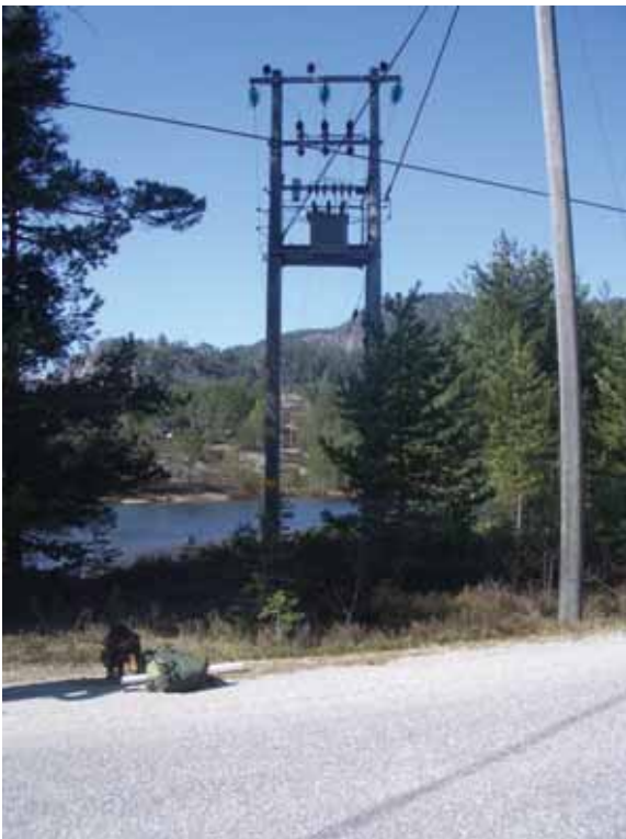
Bilde 12: Eksisterende 22 kV mast ved Kyrkjeneset. 22 kV jordkabel vil kobles til fordelingsnettet her.
