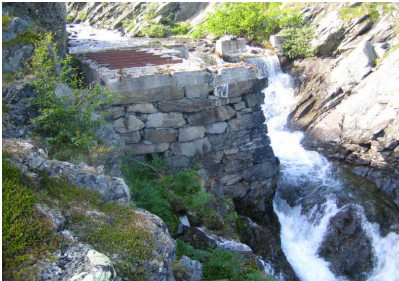
Bilde 1: Det gamle inntaket. Gammelt rør med rennende vann så vidt synlig i nedkant
