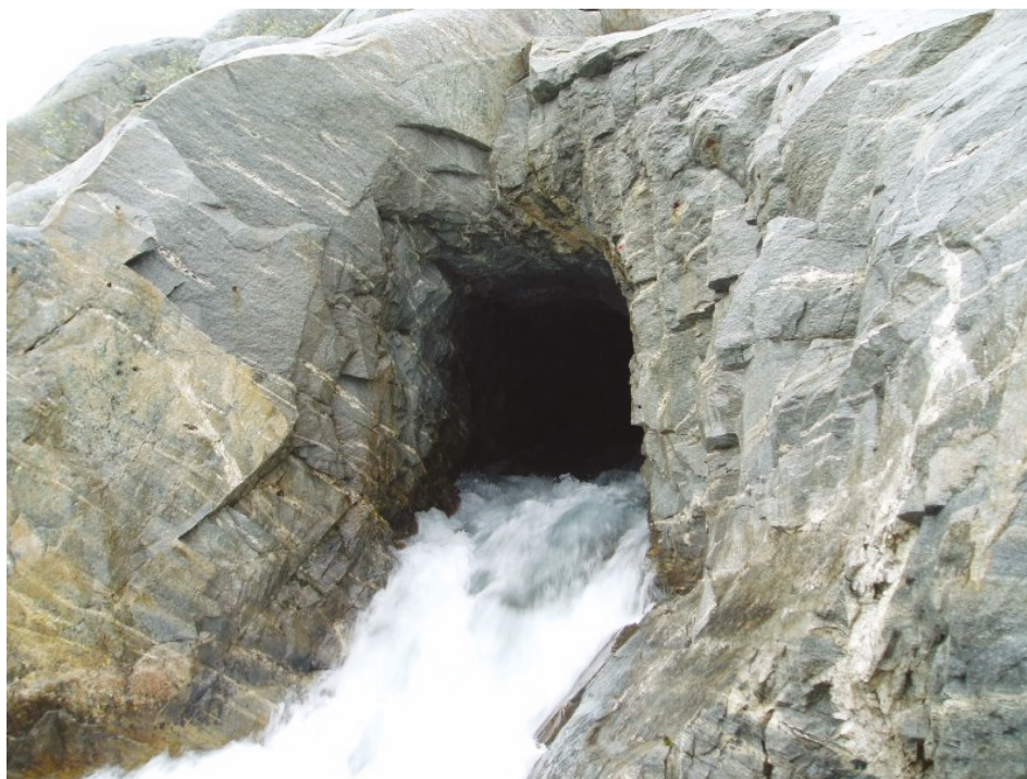
Bilde 4.4. Utløp av eksisterende overføringstunnel fra Sjuniofemtivatnet.
