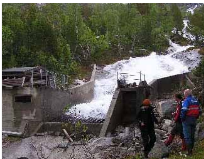
Figur 3.2. Eksempel på et bekkeinntak liknende bekkeinntakene i Vestsideelvane. Bildet viser et 40 år gammelt inntak i Skreabekken, Trollheim kraftverk.
