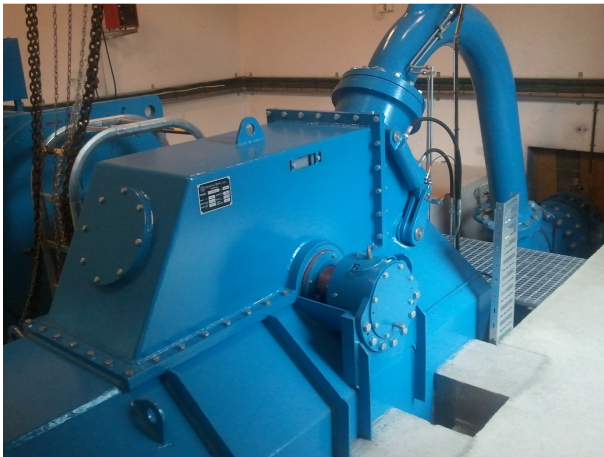
Turbin i kraftstasjon
