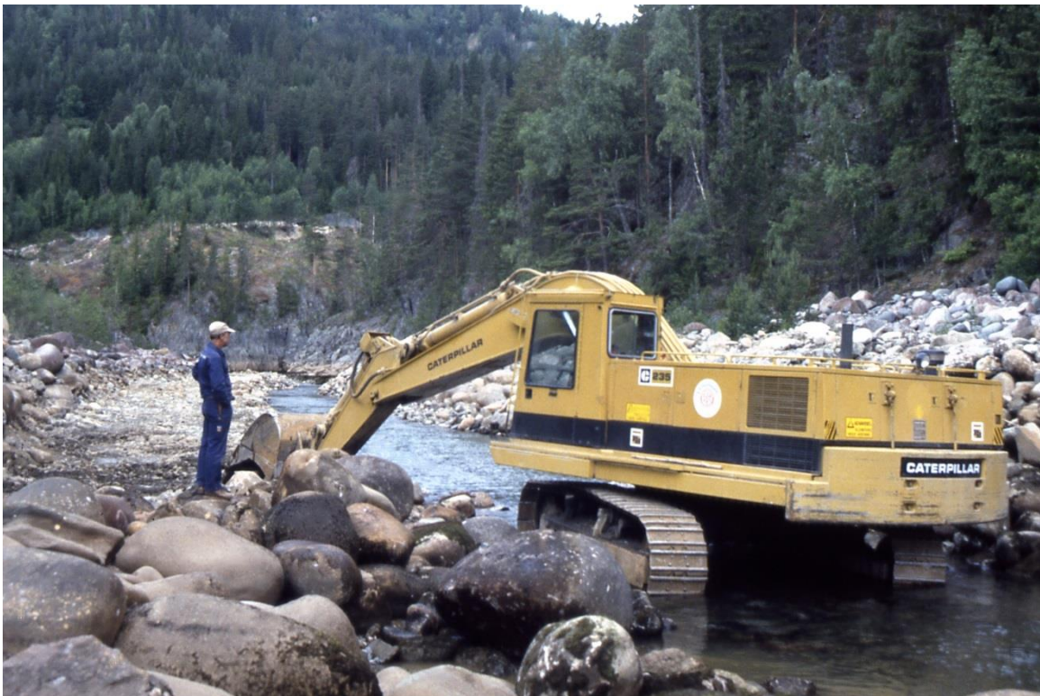
Regulanten gjer utretting og senking av elveløp nedanfor Åmøte-Bruhylen i 1986 med 70 tonns gravemaskin.
