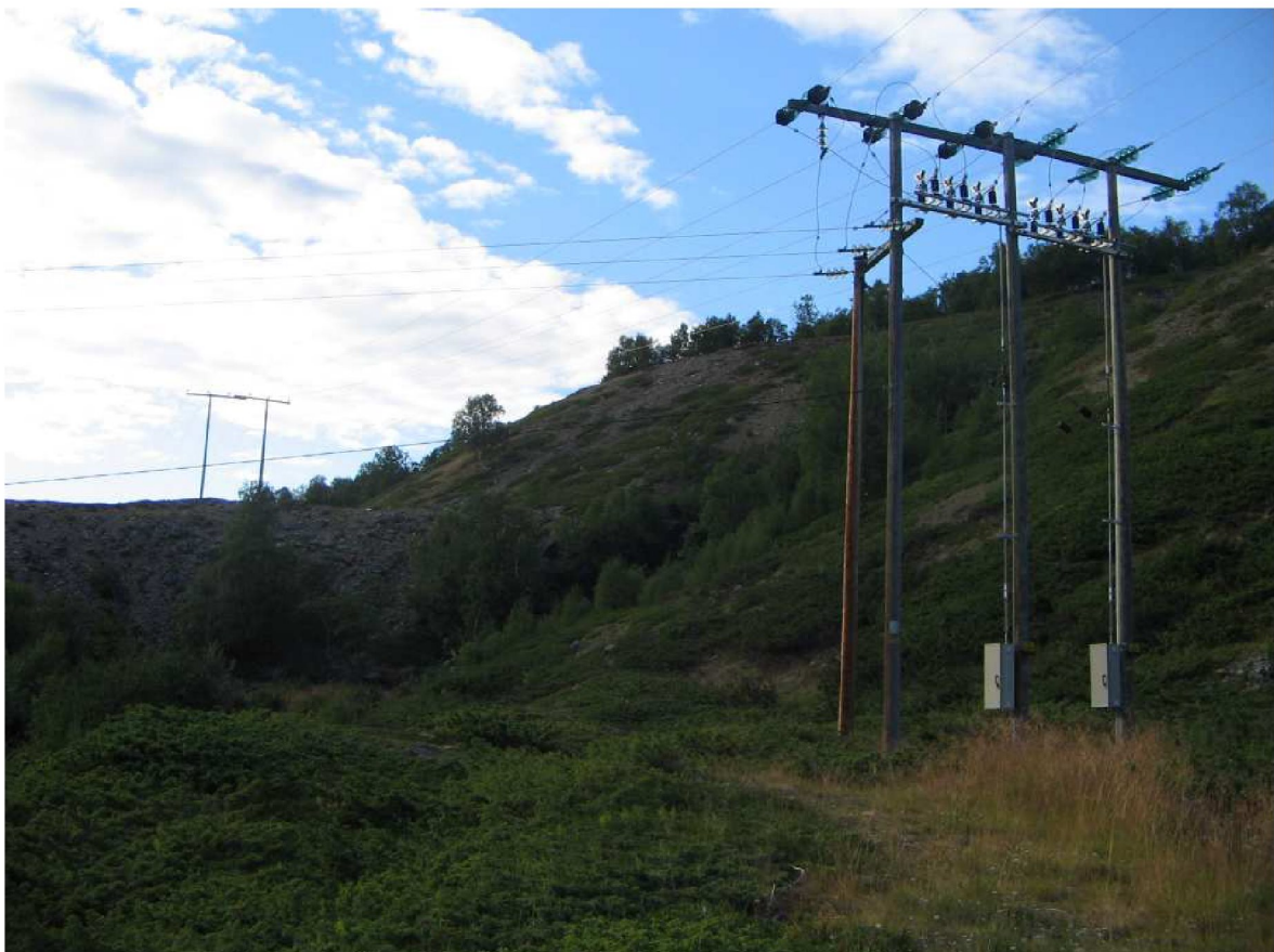
Bilde 5.2 Eksisterende 22 kV nett
