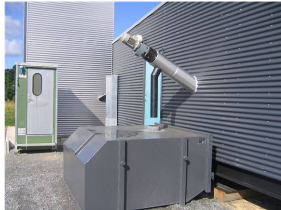
Prefabrikkert bioenergisentral m/askecontainer (foto: SWECO Grøner AS)
