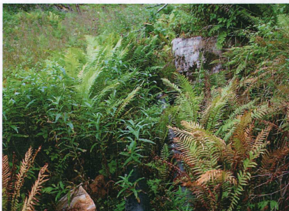
Bilde 7 Det er kraftig bregnevegetasjon i området - ikke mye som vises av vannledningen som ligger oppå bakken
