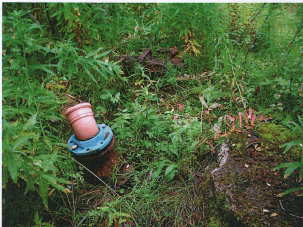
Bilde 10 Gjengrodde deler av det nedlagte vannverket ved utløpet av Sommarsetelva
