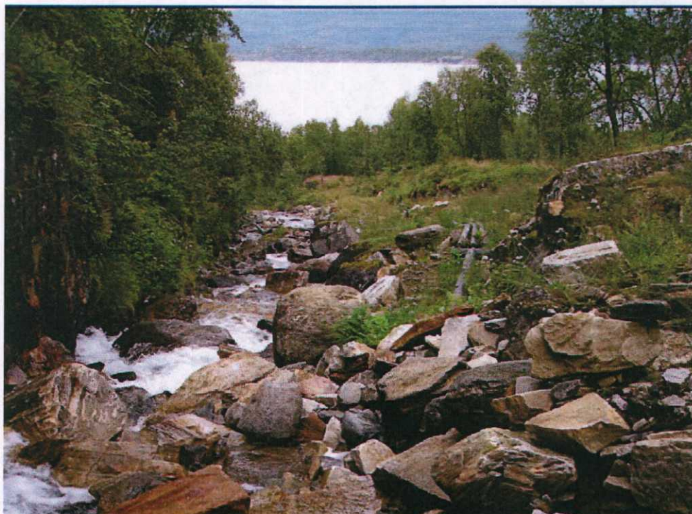
Bilde 3 Tatt fra inntaksdammen – sett nedover elva. Inntaksledningen fordeles til 3 stk 200mm PEH-rør (litt til høyre for midten av bildet)
