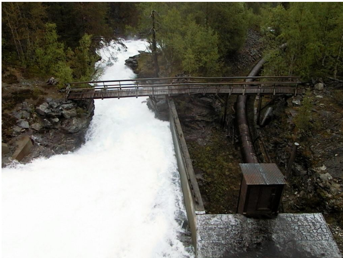
Overløpet. Inntak og rørgate
