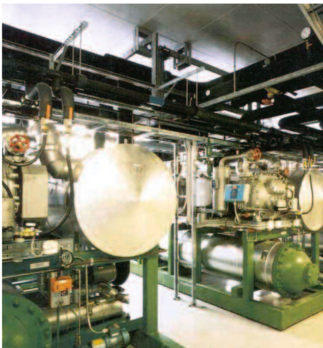
Sjøvannsvarmepumpe ved StatoilHydros Forskningscenter på Rotvoll i Trondheim. Anlegget består av 2 varmepumpeaggregater, hver med 450 kW varmeytelse. Sjøvann hentes fra 60 meters dyp. Anlegget ble startet opp i 1992. I dag installeres langt større varmepumper, blant annet planlegges en med 26 MW effekt på Fornebu utenfor Oslo. Bildet er tatt av StatoilHydro
