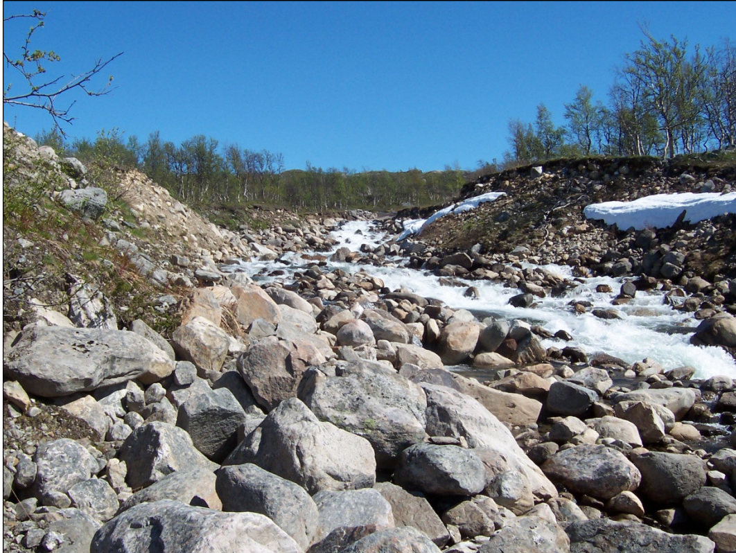
Bilde 8: Som bildet viser er det til dels store erosjonsskader i nedre del av kunstige Sølvbekken.
