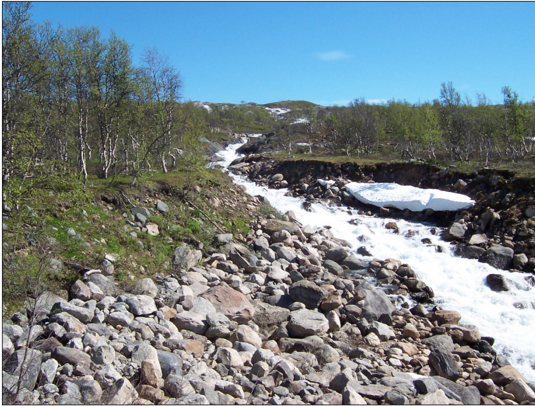
Bilde 9: Som bildet viser er det til dels store erosjonsskader i nedre del av kunstige Sølvbekken.
