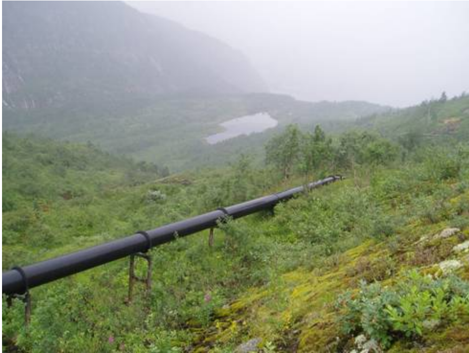
Foto 6. Røret som fører vannet fra Øvre Glomvatnet til kraftstasjonen. Hydrodammen skimtes nedenfor.
