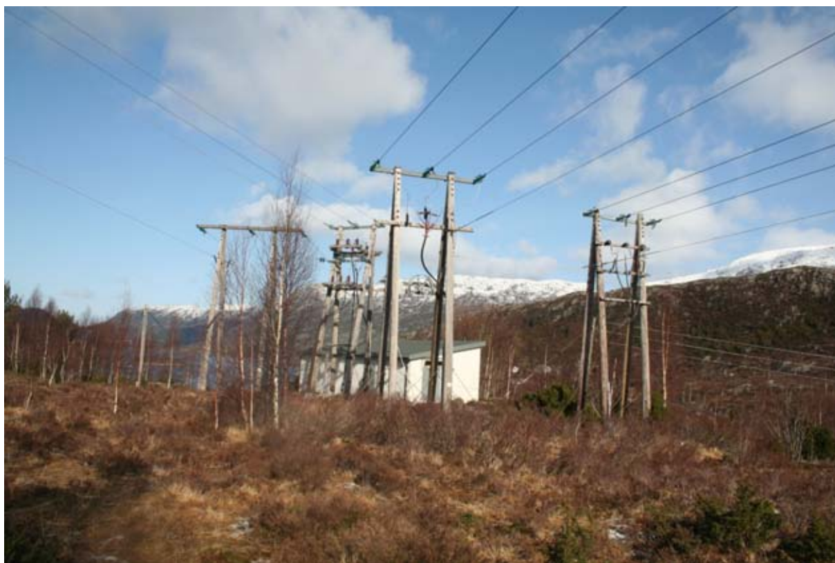
Fig. 4. 22 kV koblingsstasjon i Åmdalsvik.
