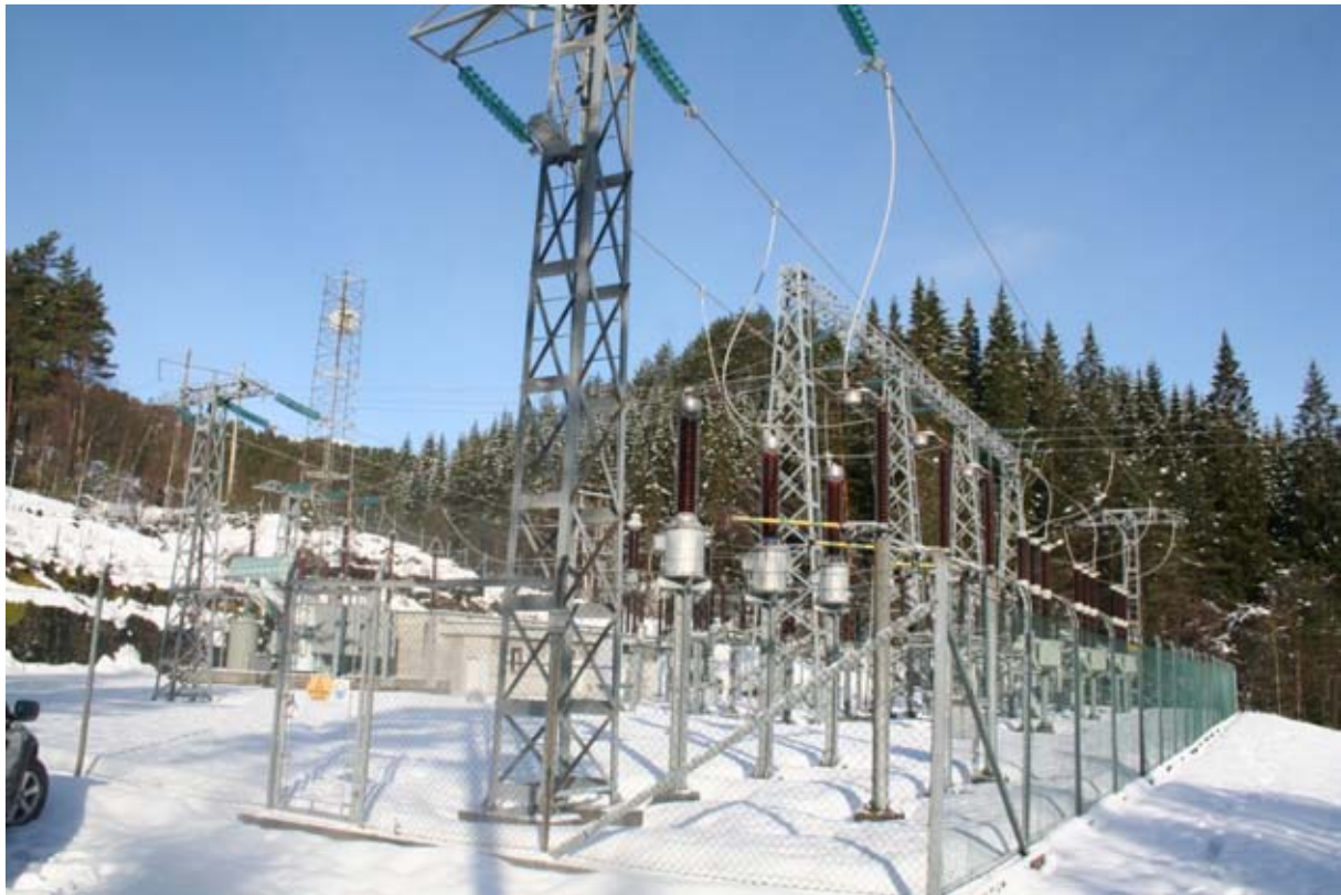
Fig. 1 Eksisterende trafostasjon Frøyset.
