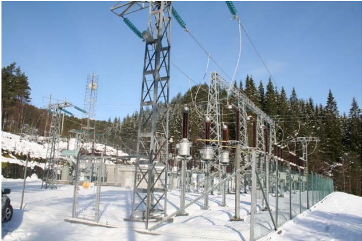
Fig. 1 Eksisterende trafostasjon Frøyset.
