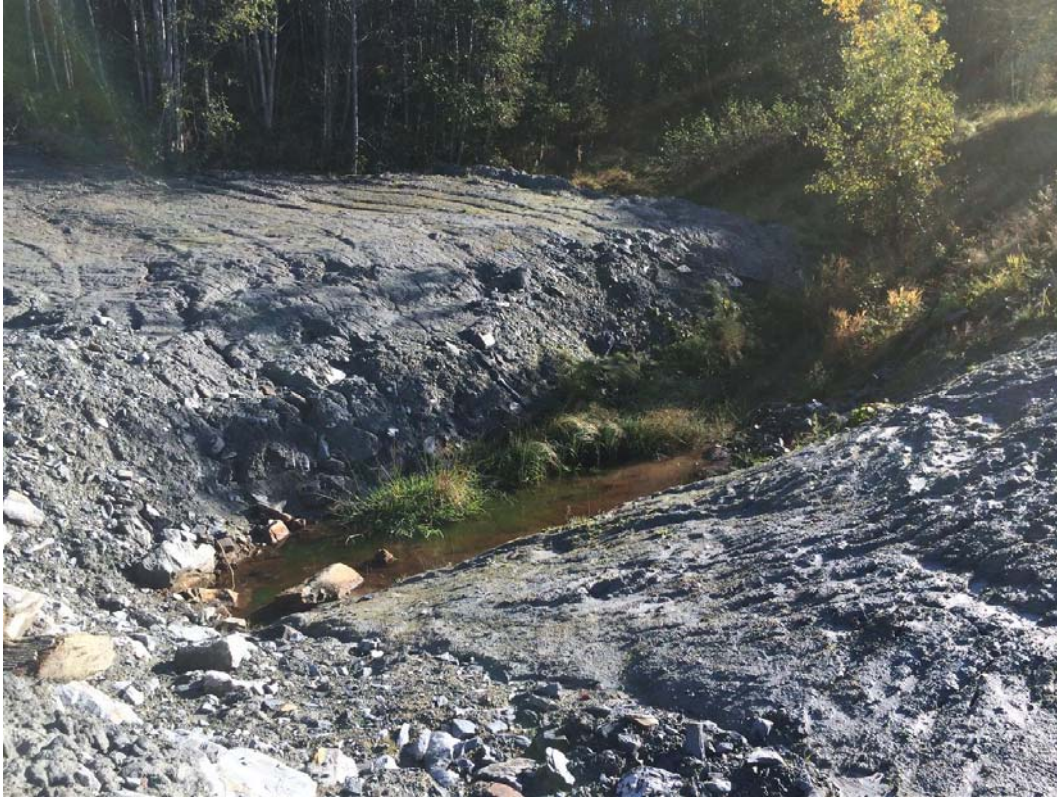
Bilde 6: Finnmyrbekken. Ravine dal i P300. Utløp rør for overvann innmålt med GPS: «Bunn roer2». Røret må forlenges eller overvann må legges åpen i ravina i øst.
