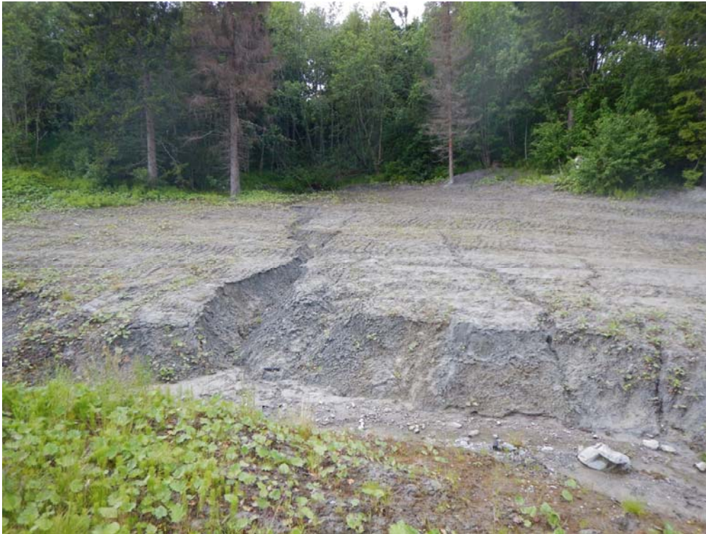
Figur 15: Sunndalsbekken. Erosjon i leirmassene ca. P500, venstre side
