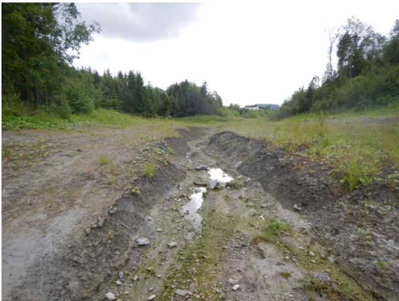
Figur 3: Erosjon i leirmassene ca. ved P550 i Finnmyrbekken
