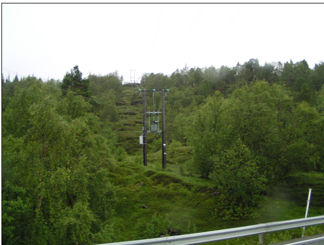
Figur 6 Høyspentline krysser E6 ved Larsberg tunnelen, og går over mot Røykenes/ Skibotn. Rørtrase fra inntak til Larsbergelva kraftverk vil krysse under høyspentlinjen, og tilkobling vil skje til denne oppe på heia, ikke synbart fra veien.
