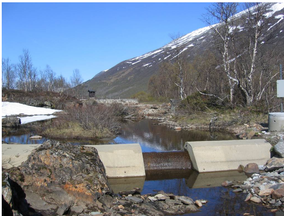
Installasjon for slipping av vann ved Dalsvatnet i øvre ende av nedslagsfeltet
