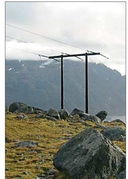
Eksempelbilde 132 kV mast.
