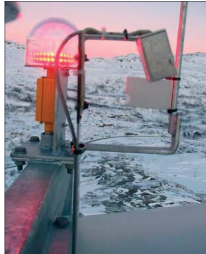
Isingssensor montert på eksisterende turbin Nygåtdsfjellet trinn I.
