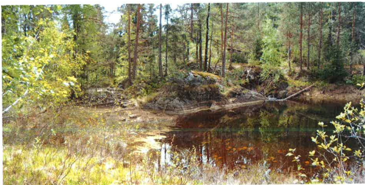
Attholdsdam i Ljøsvannet , intakt steinfyllingsdam til venstre, forvitret del av attholdsdam med vannføring til høyre på bildet.
