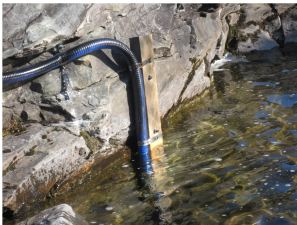
Bilde 9: Vannføringsmåler ble installert i September 2008
