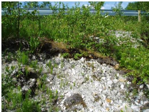
Bilde 9 Erosjon i veifyllingen nær E6
