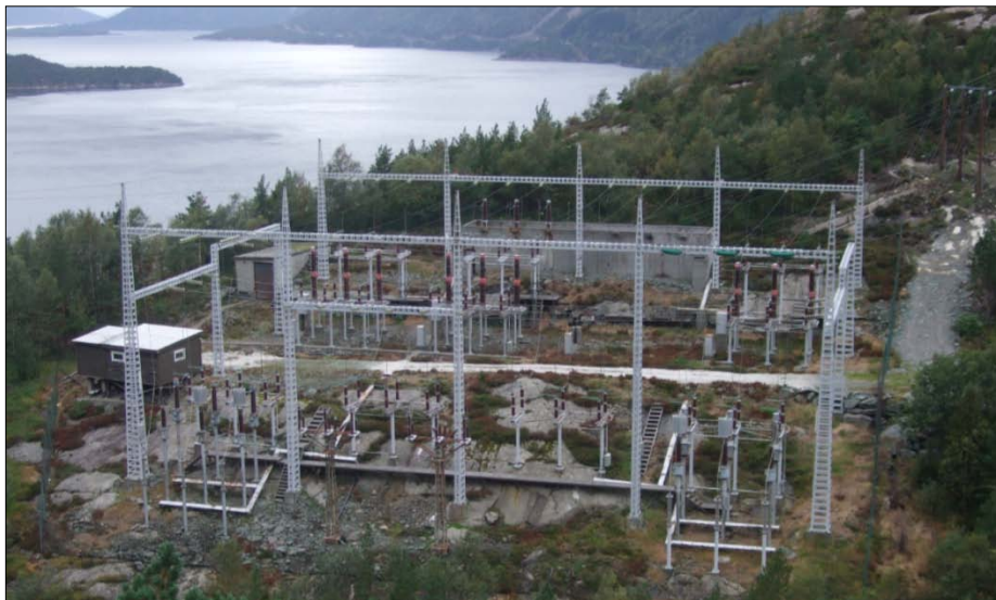
Figur 5. Foto av Svelgen trafostasjon. (Foto: Jøsok Prosjekter AS).
