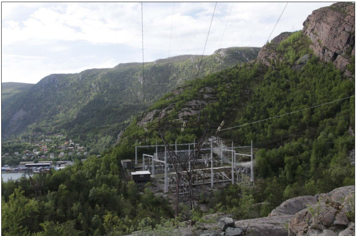
Bilde 16. Den nye 132 kV linja vil bli koblet til eksisterende transformatorstasjon øst for Svelgen.
