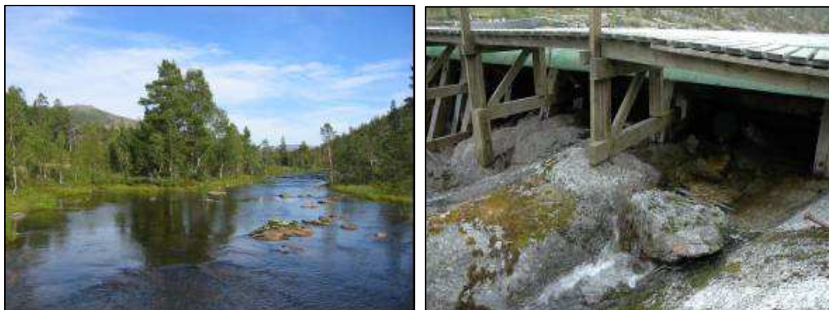
Figur 13. Vannspeil og effektene av lekkasjevann ca. 200–300 m nedstrøms dam (venstre) og lekkasje gjennom dammen i vestenden av Mjøsundvatn (høyre).
