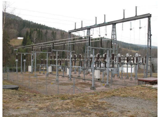
Figur 7-32 Bildet viser et typisk koblingsanlegg av typen som er tenkt etablert ved Øyan. (Foto: Skagerak Kraft )
