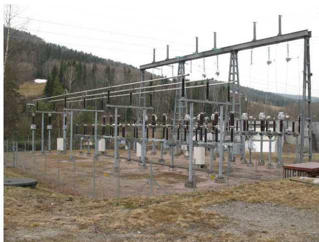
Bilde 8-4: Bildet viser et typisk koblingsanlegg av typen som er tenkt etablert ved Øyan. (Foto: Skagerak Kraft AS)
