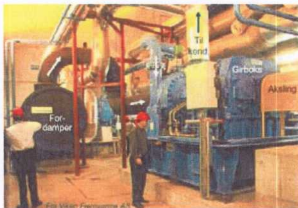
Figur 4-6 Norges største varmepumpe på 18 MW
