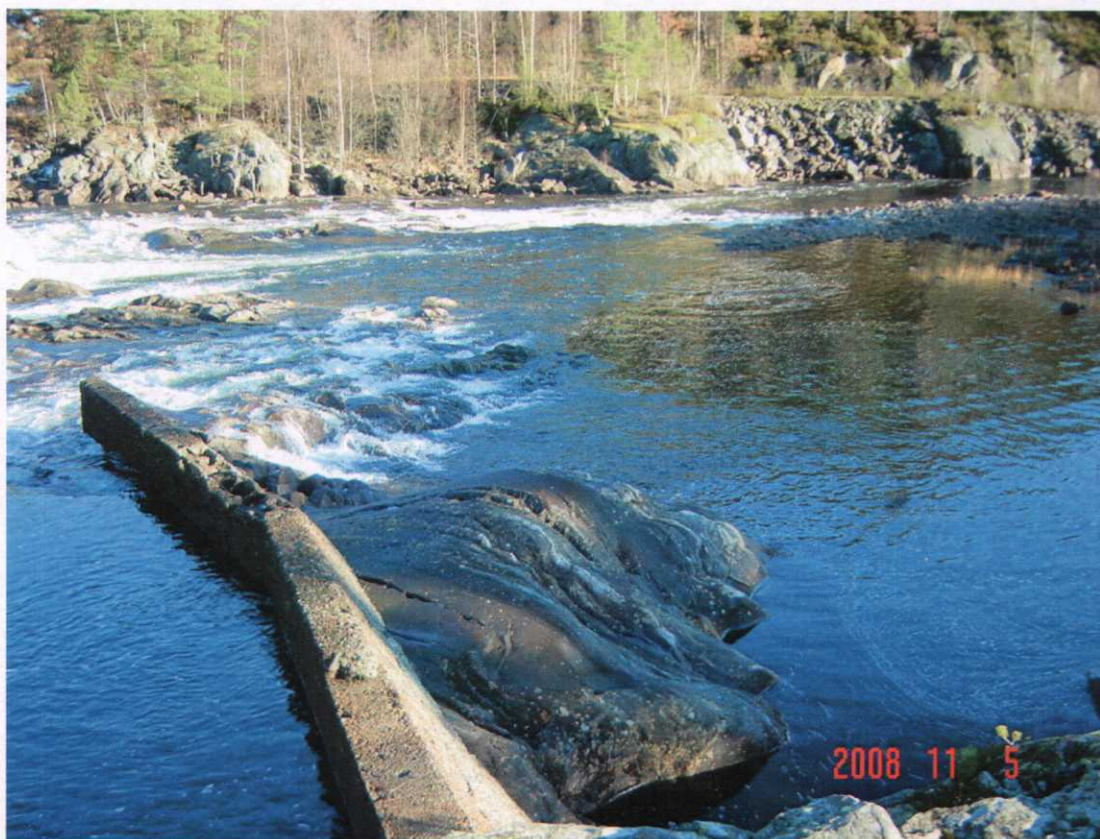
Figur 8. Bilde nr 167. Gammel fløtningsmur nedstrøms badestedet. Slipp av 16 \text{ m}^3/\text{s} .
