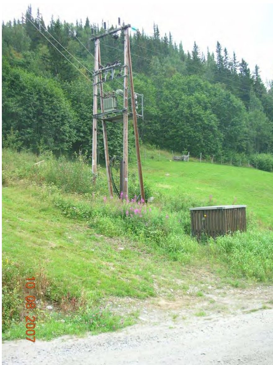
Bilde nr. 3. Området ved Sønstegard der 22kV kraftlinje er avslutta og går over til 230V fordelingsnett.
