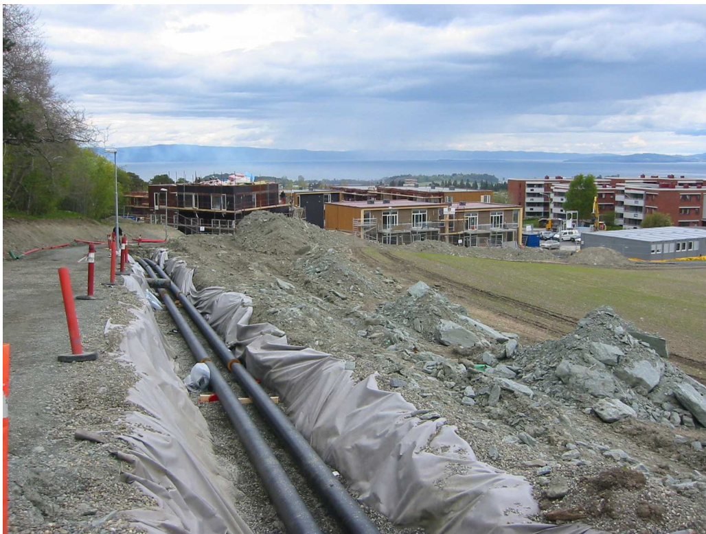
Bilde av en fjernvarmetrase.
