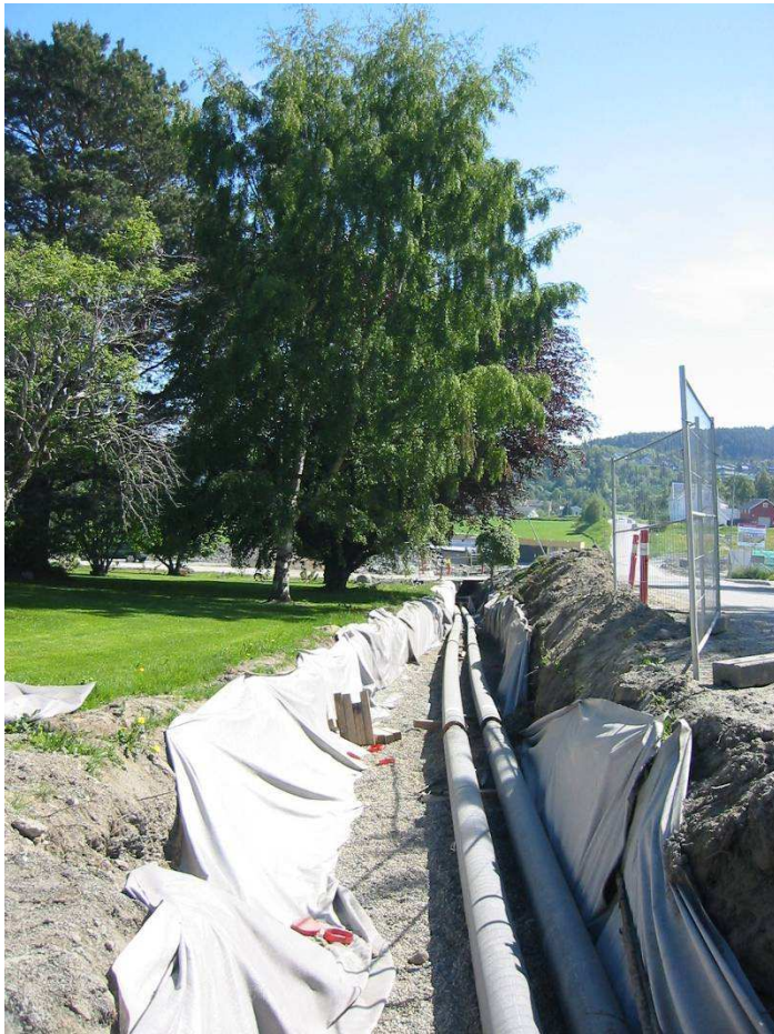
Bilde av en fjernvarmetrase.
