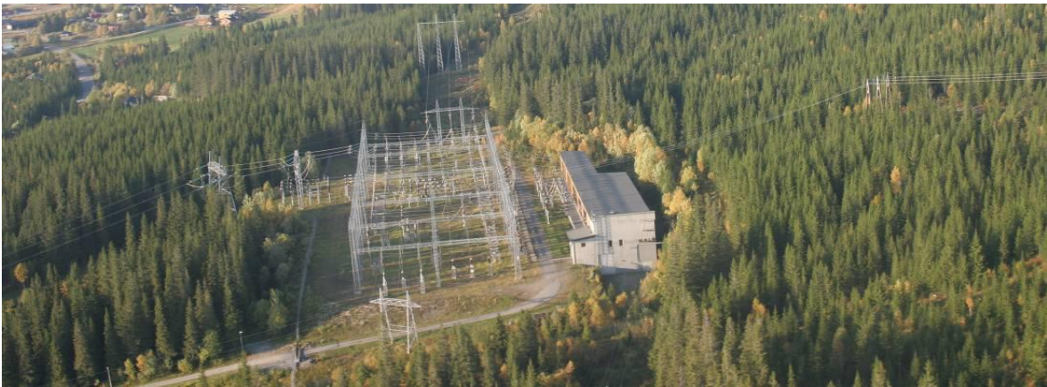
Figur 4.16. Eksempel på en 300 kV trafostasjon (bildet viser NEA kraftverk). Er kun ment som en illustrasjon på hvordan et 420 kV utendørsanlegg kan bygges. Et mulig 420 kV utendørsanlegg i nordre delområde vil bli noe mindre enn det som bildet illustrerer.
