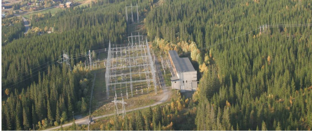
Figur 4-5. Eksempel på 300 kV trafostasjon (bildet viser NEA kraftverk). Lengden på utendørsanlegget er realistisk, men bredden er i størrelsesorden halvparten av hva figuren viser.
