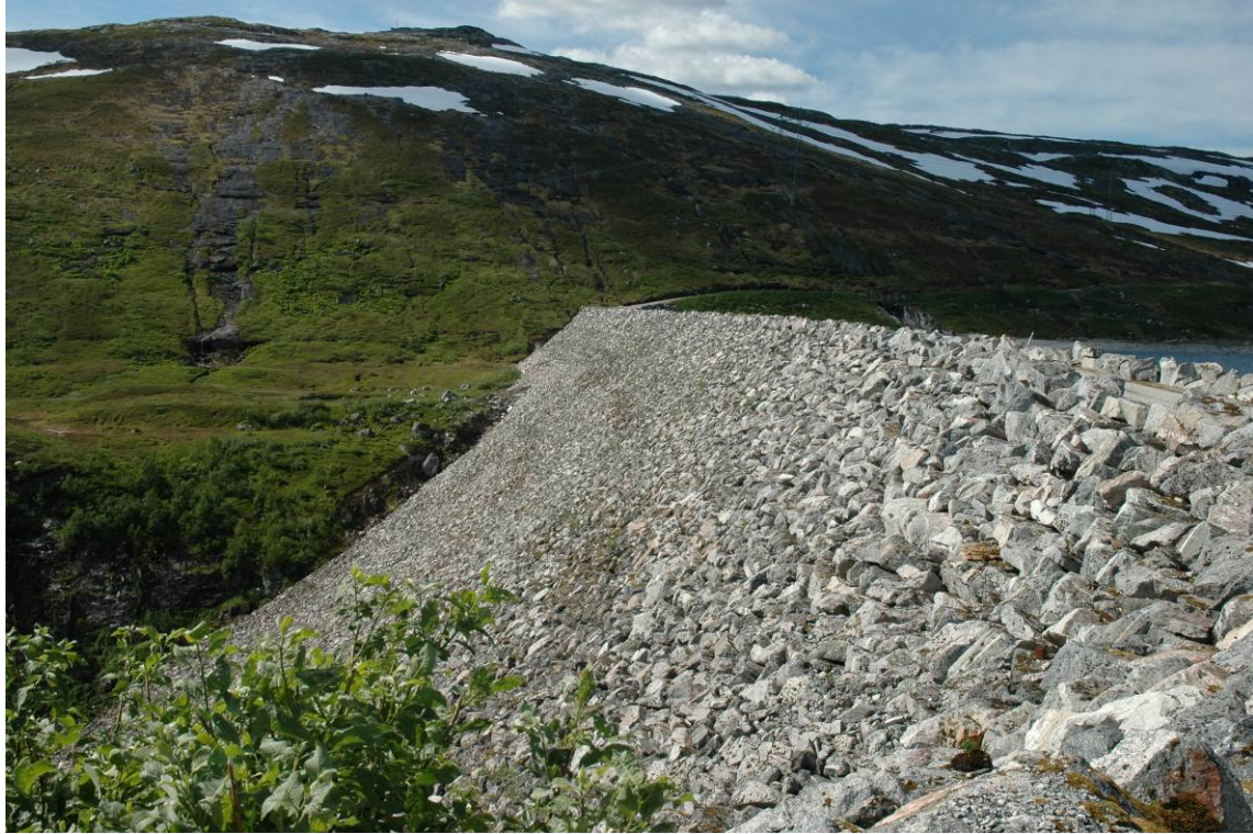
Figur 5-6 Vannkraftutbygging ved Øvre Kalvatnet – her vises dammen. I bakgrunnen sees det nordligste planområdet for vindkraftverket. Foto: Christine R. Wist, SWECO Grøner.
