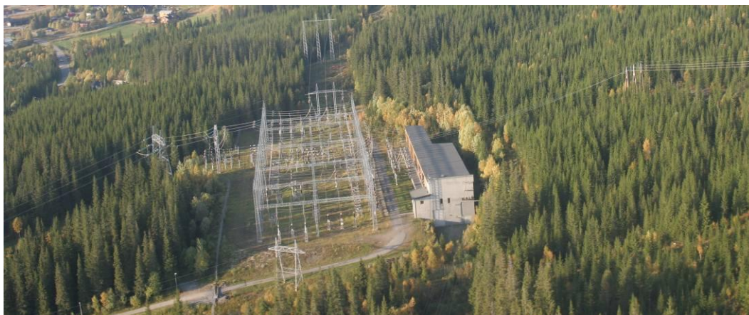
Figur 5. Eksempel på 300 kV trafostasjon (bildet viser NEA kraftverk). Lengden på utendørsanlegget er realistisk, men bredden er i størrelsesorden halvparten av hva figuren viser.
