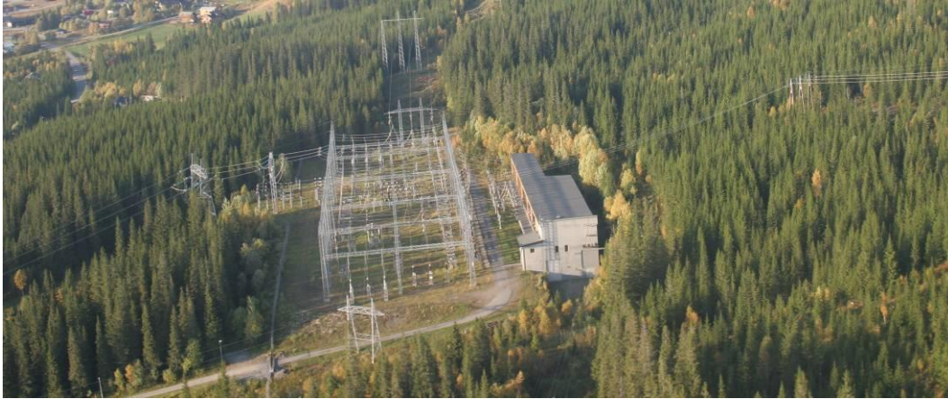
Figur 7 Eksempel på 300 kV trafostasjon (bildet viser NEA kraftverk). Lengden på utendørsanlegget er realistisk, men bredden er i størrelsesorden halvparten av hva figuren viser.
