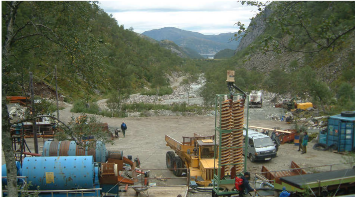
Figur 2.4. Fra området ved gullgruven i Bogadalen, sett mot N. I bakgrunnen sees veien som er tenkt å knytte til planlagt vei fra Urdvollan.
