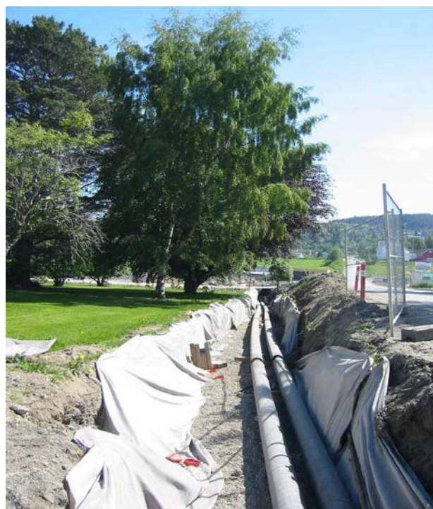
Bilde av fjernvarmetrasé.
