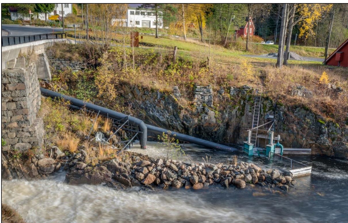
Her ser vi fiskeheisen. I prinsipp handler denne konsesjonssøknaden om hvordan dette lokkevannsrøret (som vinkler rett ned) kan erstattes med et minikraftverk.
