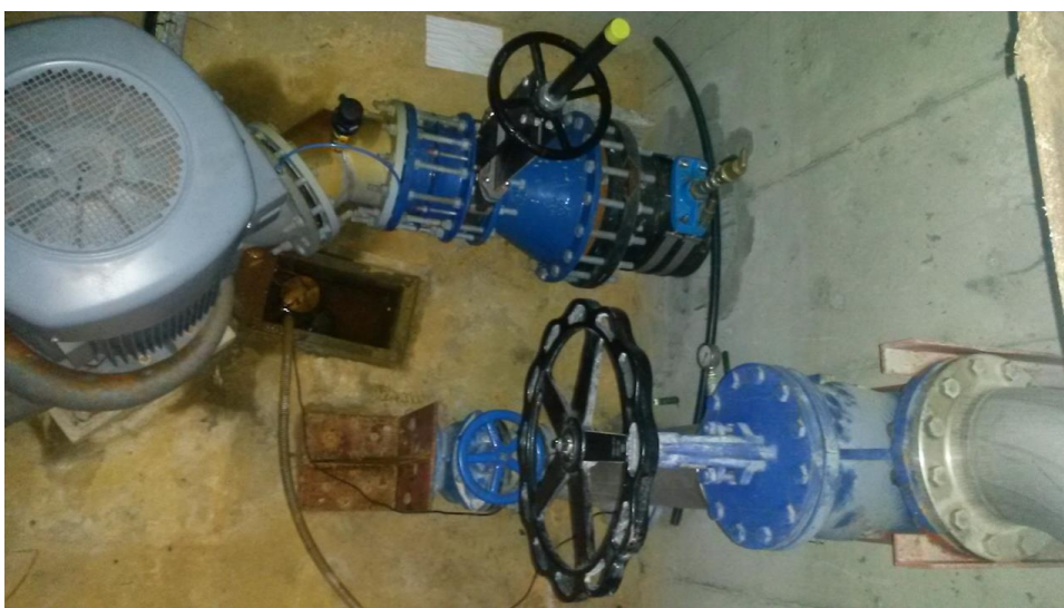
Figur 1.5 Pumpekum med tørroppstilt pumpe på ledning fra inntak og med ventiler for stenging / åpning samt egen rørledning med stengeventil fra turbinrør/reduksjonsventil.
