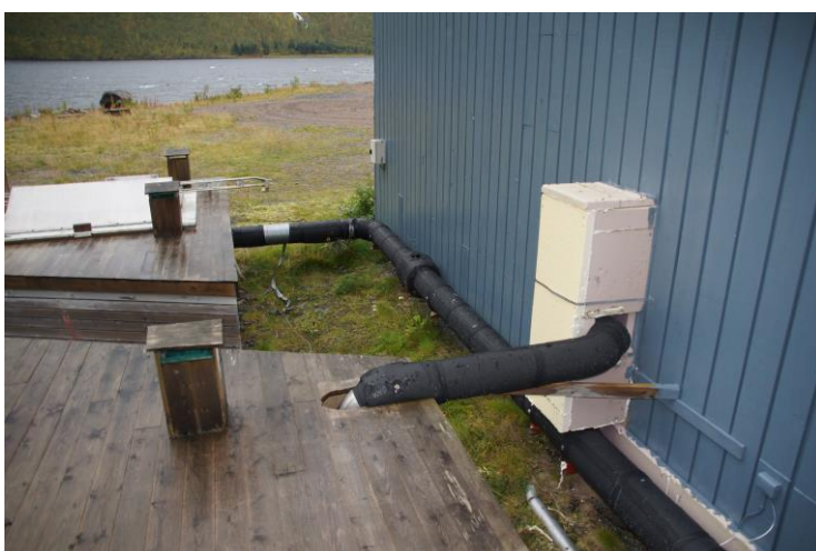
Figur 1.6 Vannledning fra turbinrør/reduksjonsventil bakerst og vannrør fra frostsikring.
