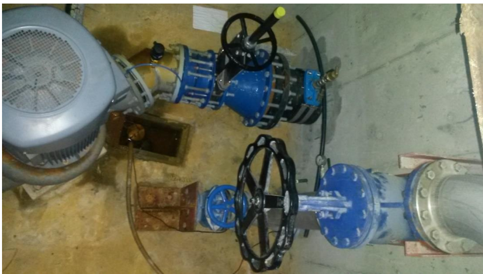
Bilde 8. Pumpekum med tørroppstilt pumpe på ledning fra inntak og med ventiler for stenging / åpning samt egen rørledning med stengeventil fra turbinrør/reduksjonsventil.
