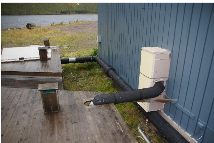
Bilde 9. Vannledning fra turbinrør/reduksjonsventil bakerst og vannrør fra frostsikring.
