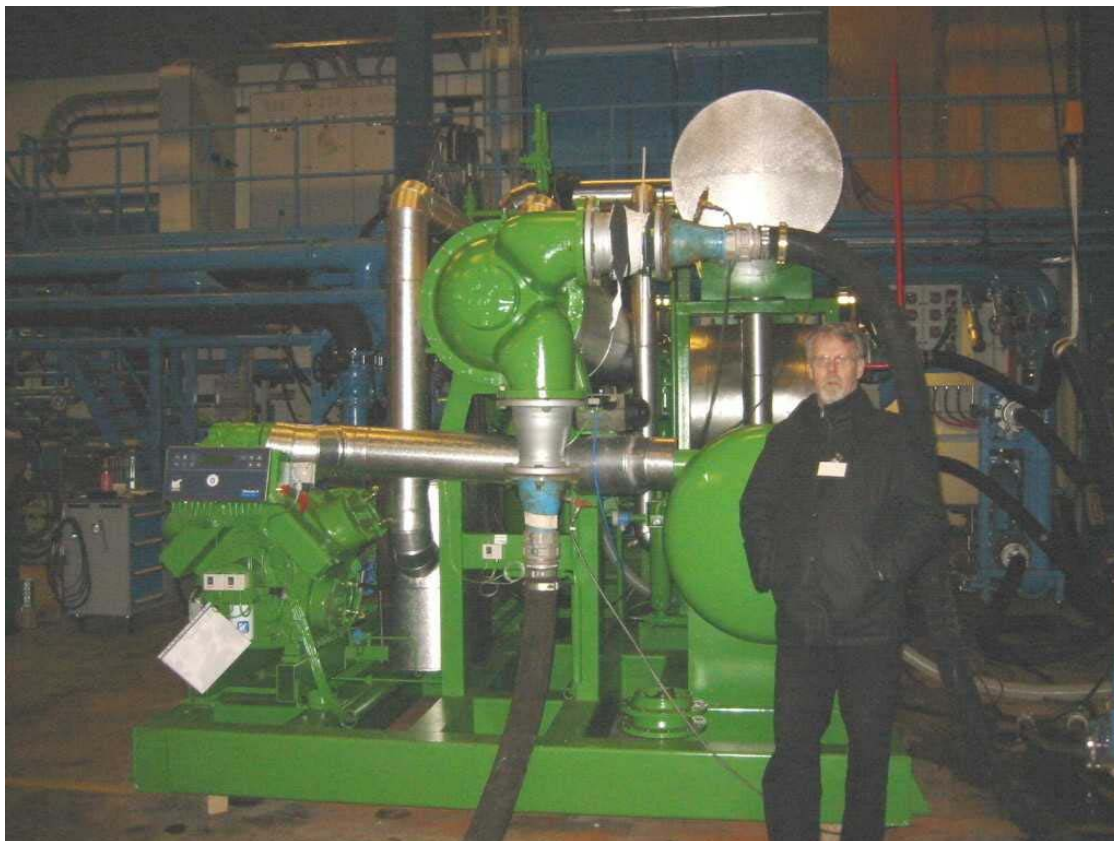
Figur 3. Bilde av to-trinns NH 3 - varmepumpeanlegg
