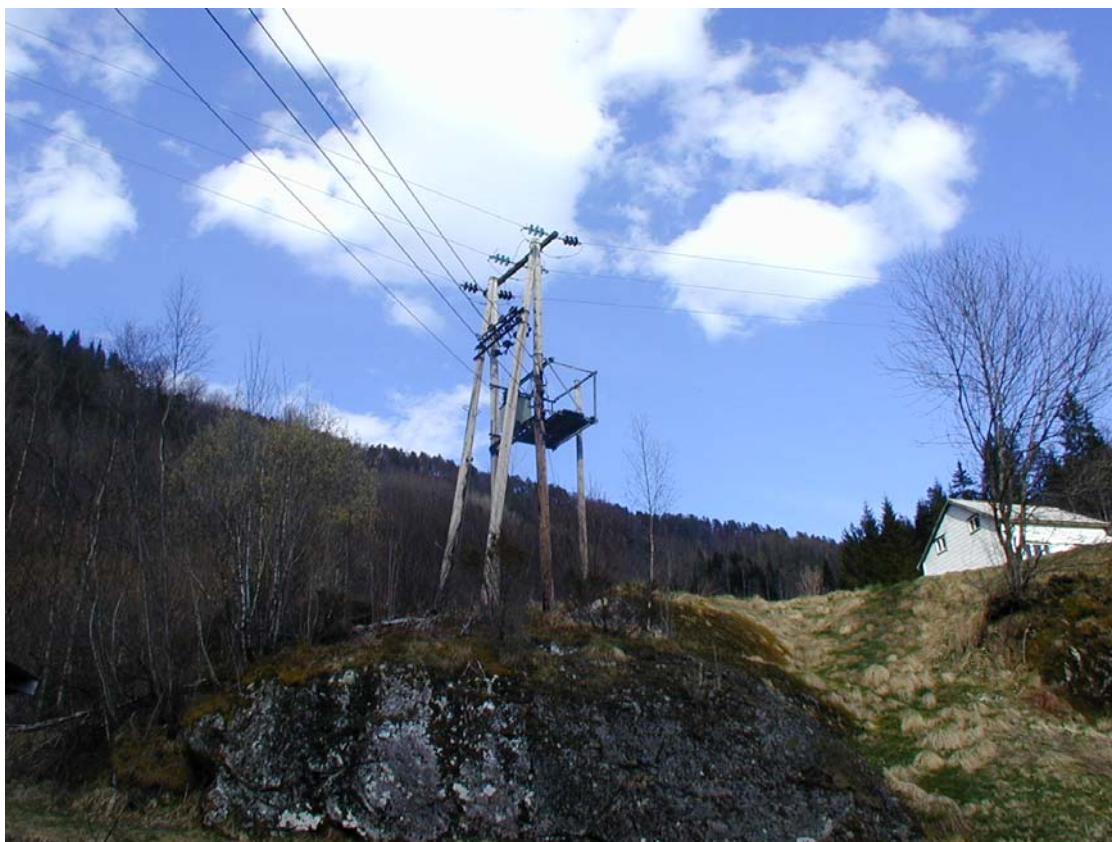
Brytarmast – planlagt tilknytningspunkt 22 kV.
