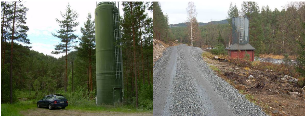
Bildet til venstre viser kalkdoserer i Skjeggedalsåna nedstrøms Skjeggedalsfoss, men bildet til høyre viser kalkdoserer i Vatndalselva. Fotos: Ole Roer.
