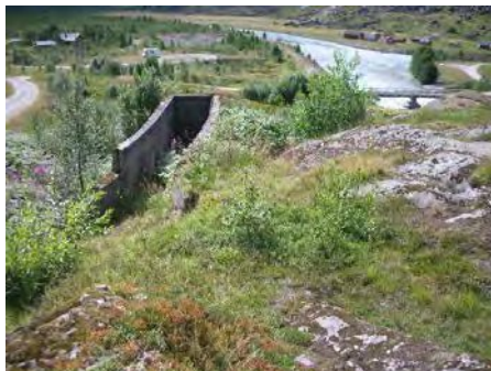
Ruin etter dam/vassrenne.
