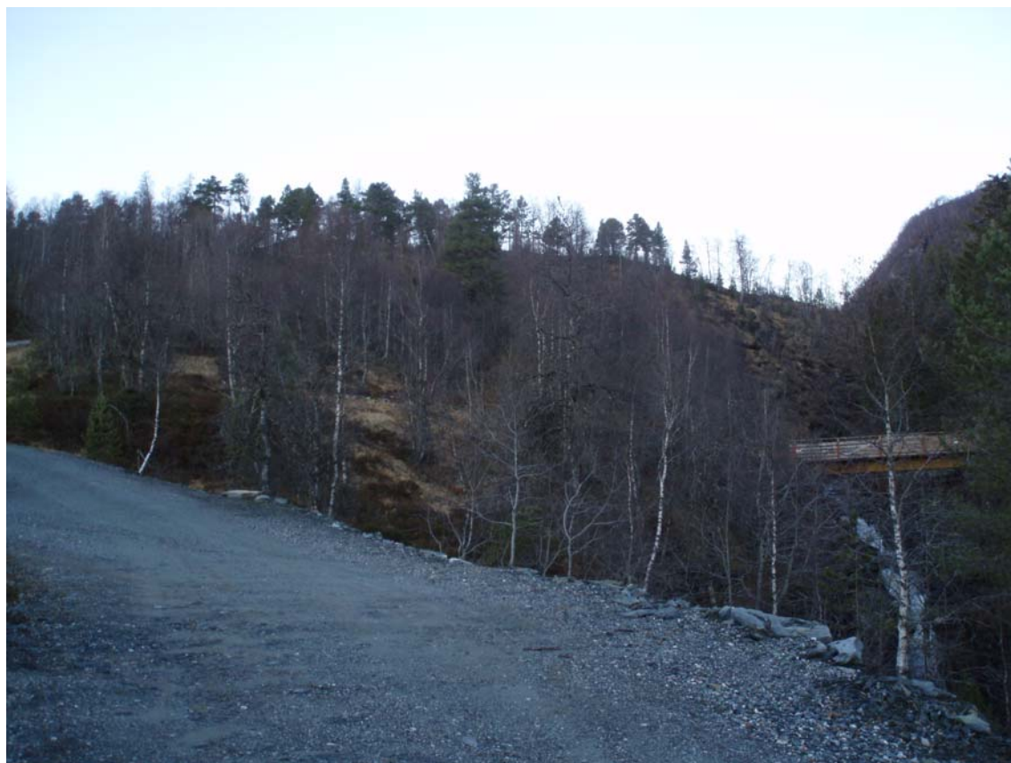
Foto 3 Ovenfor kraftstasjonen blir røret liggende delvis i veien.
